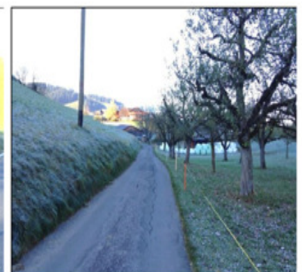
Längsrisse, Setzungen talseitige Strassenhälfte
