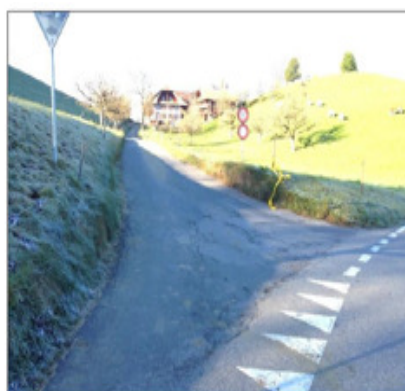
Wilde Risse beim Anschluss an die Kantonsstrasse
